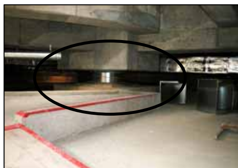
写真-1 免震装置（積層ゴム系）
