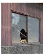
窓が割れた管理不全空家
