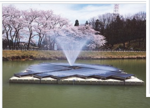
水上式太陽光発電システム (富山県射 水市、2010年 (平成22年) 4月)
